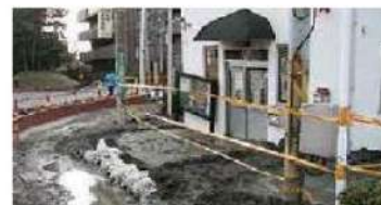
地盤沈下により傾いた交番
