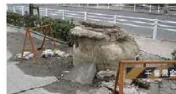
押し上げられたマンホール
