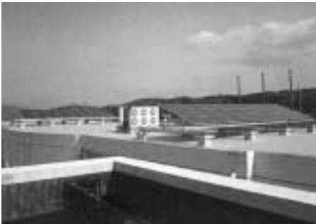
南中学校校舎屋上に設置された太陽光発電装置
