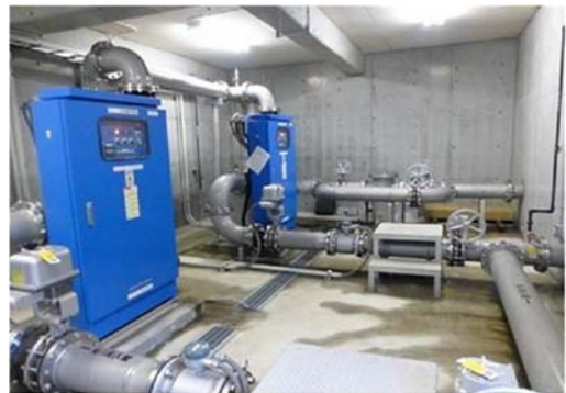
岡六月窪浄水場の紫外線処理設備
