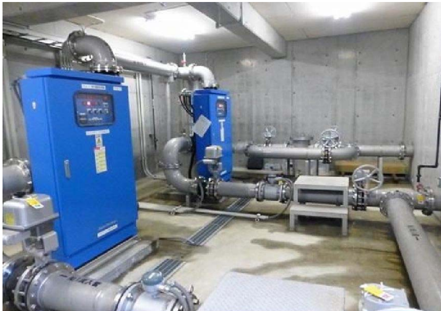
図 4.3.1 岡六月窪浄水場の紫外線処理設備
