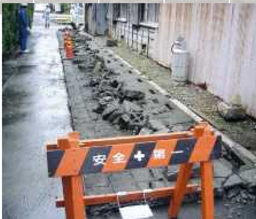
駿河湾を震源とする地震（平成 21 年 8 月 11 日発生）によるブロック塀の倒壊
