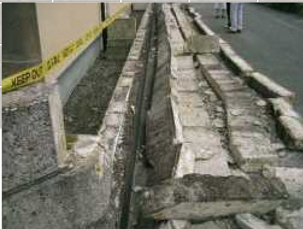
駿河湾を震源とする地震（平成23年8月1日発生）による大谷石塀の倒壊
