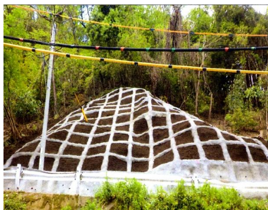
令和2年度復旧状況 林道八代田線
