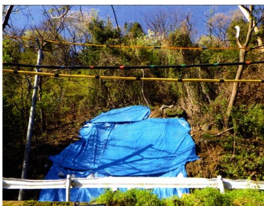
令和元年度（台風15号）災害復旧前 林道八代田線
